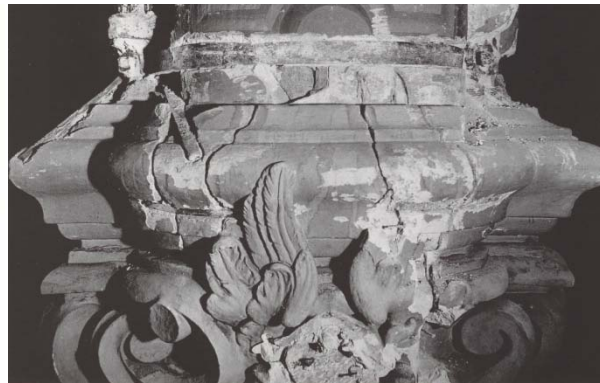
Figur 7: Trykkskader på søylekapitel, 1932
