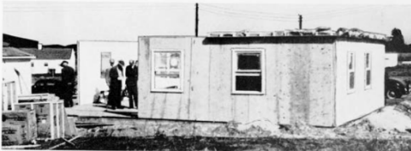
C. Kl. 1100 morgen. Vegger stort sett på plass — takkonstruksjonen påbegynt. Huset — klar til maling — var oppe kl. 1430.
