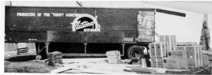
A. Kl. 0800 morgen. En stor tilhenger fra fabrikkens plasseres ved fundamentet. Den blir stående under oppsetningen og tjener som lagerskur.
