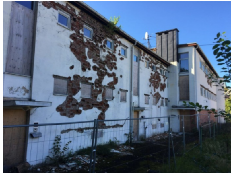
En fasade i svært dårlig forfatning. Unni Hestvedt er fornøyd med at første etasje er stengt igjen
