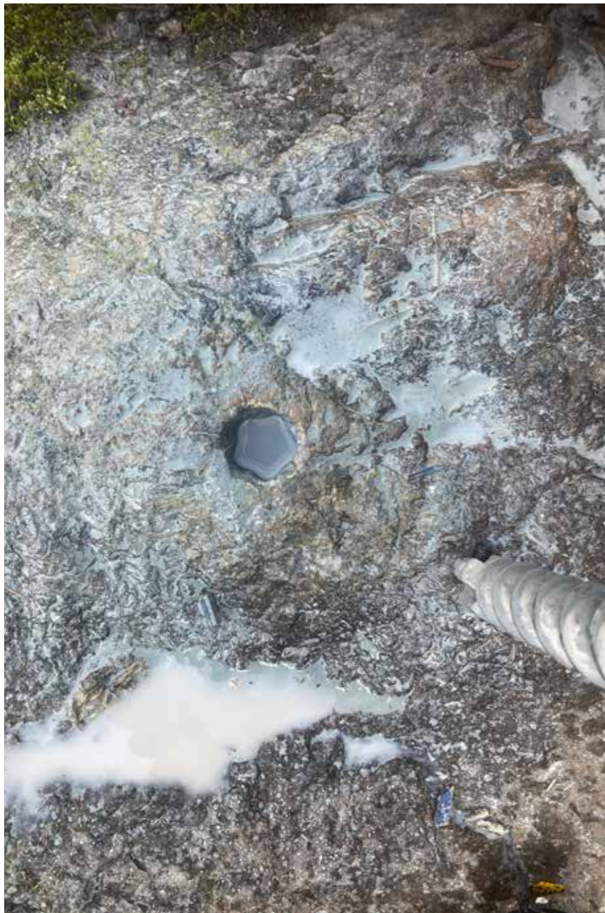
Resultatet av boring i eksisterende hull. Sement før stolpesko ble feil rekkefølge.
